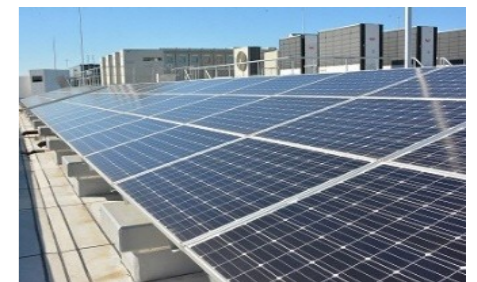
市原市役所第1庁舎（新庁舎）の太陽光発電設備
